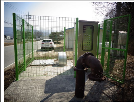
위 치 연마루 가압장 내 용 전경
